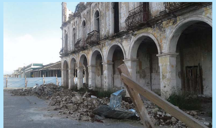
Los escombros y paredes del hotel Cosmopolita, en Camajuani, amenazan con arruinar el paseo de las carrozas, a menos de un mes de la celebración de las parrandas.
