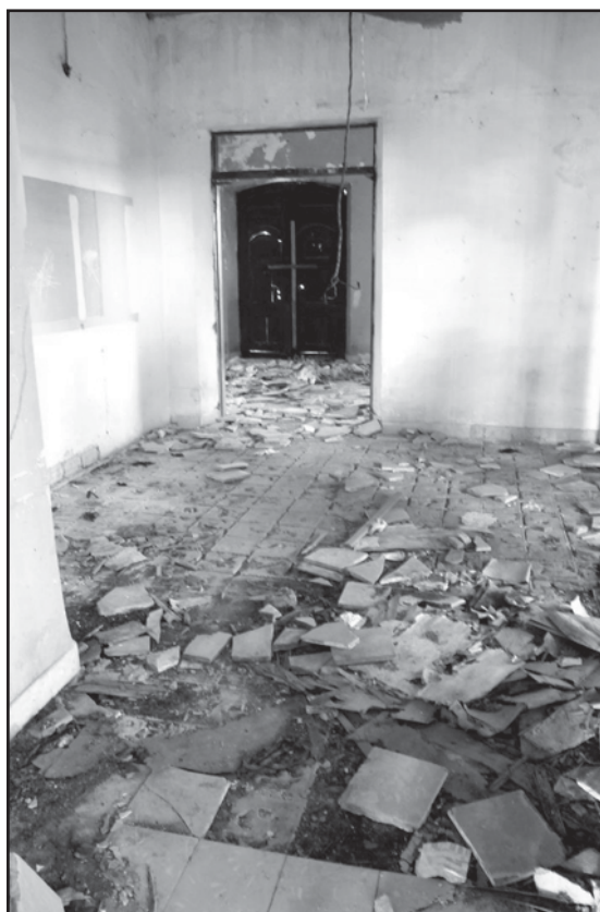
Marcos de puertas, maderas preciosas y pisos destruidos. Fueron fuentes de enriquecimiento ilícito de quienes lucran con el patrimonio cultural. (Foto: Manuel de Feria).
